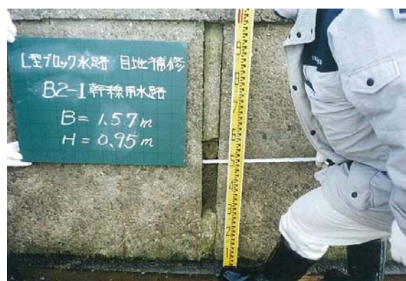
変状の(近景)接写
