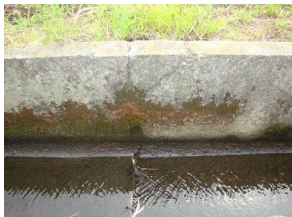
変状の(近景)接写
