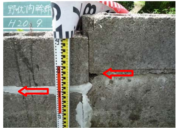
変状の(近景)接写
