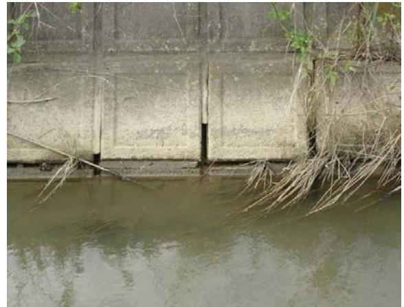
変状の(近景)接写
