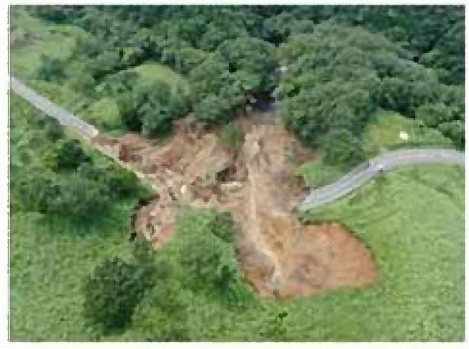
崩落した農道（南小国町）
