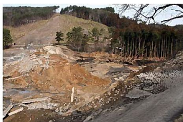
堰堤の右岸が決壊
