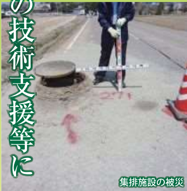
集排施設の被災
